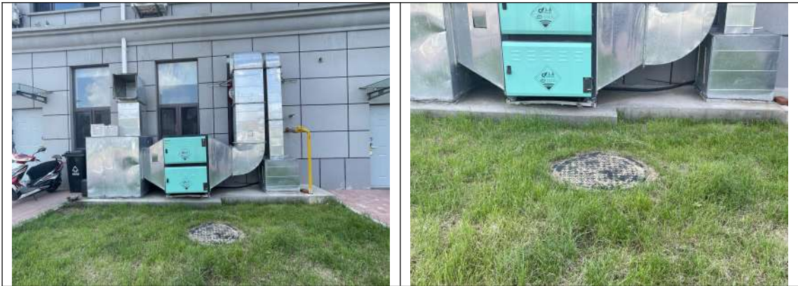
食堂油烟净化器+隔油池
