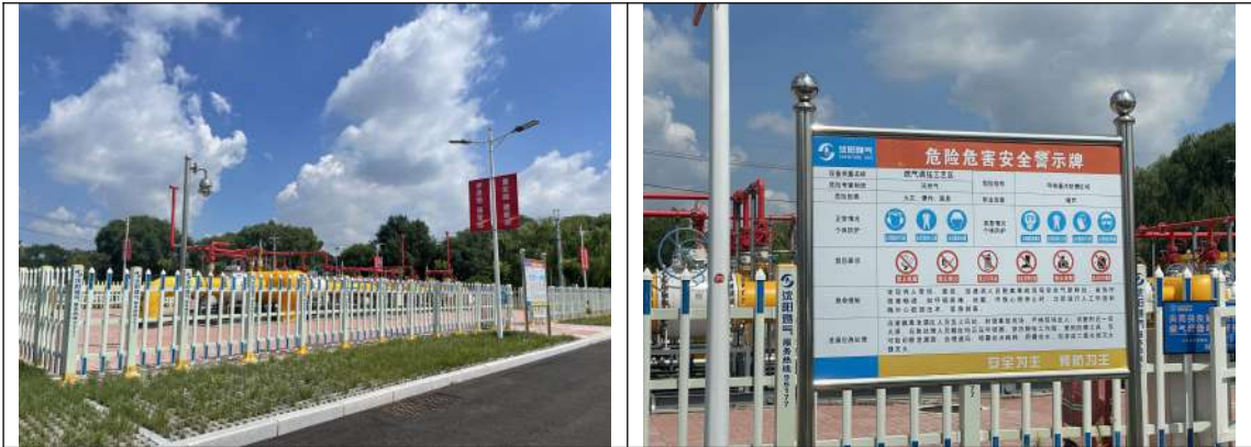
燃气调压工艺区
