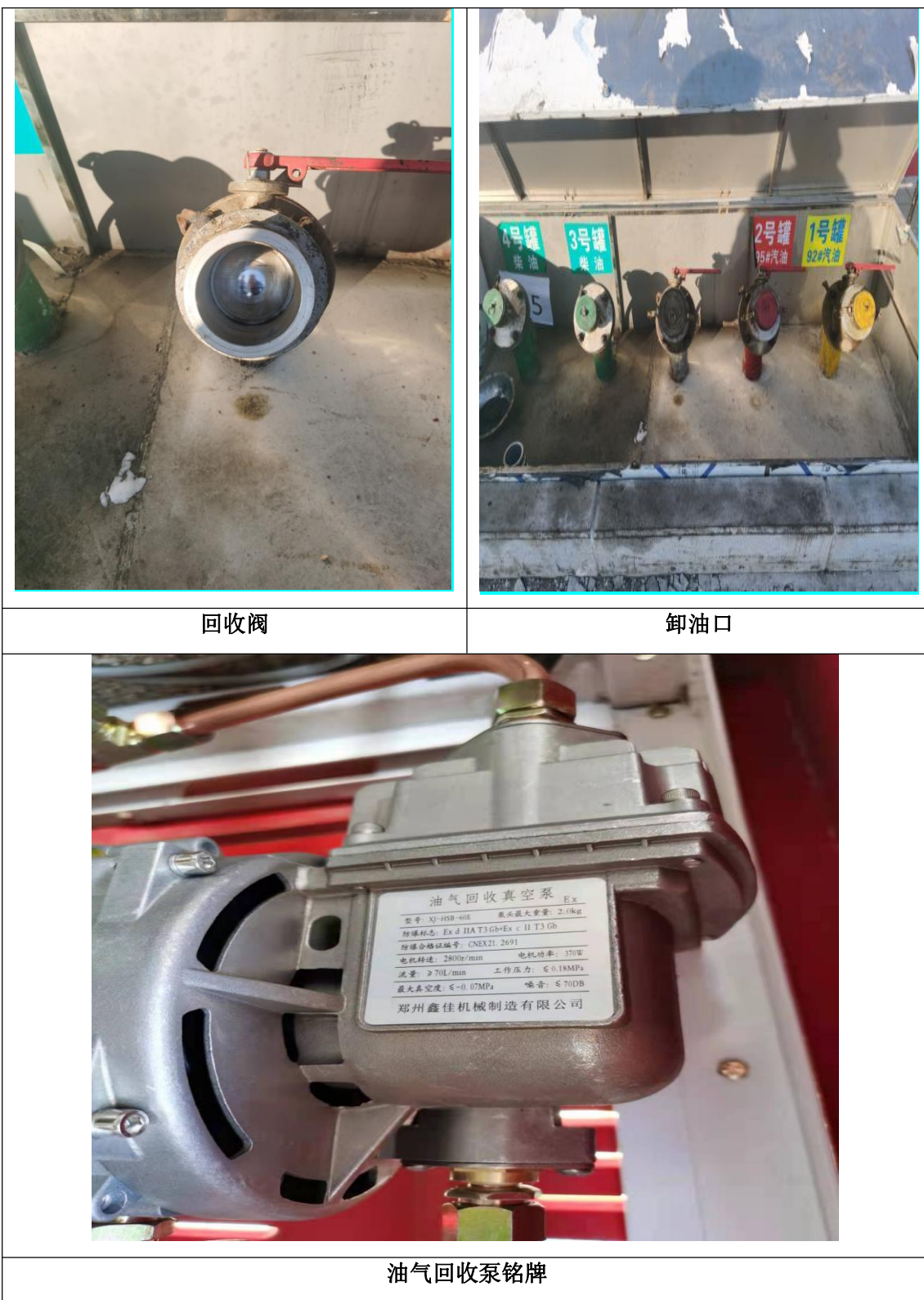
图 4.1-1 废气处理设施照片
