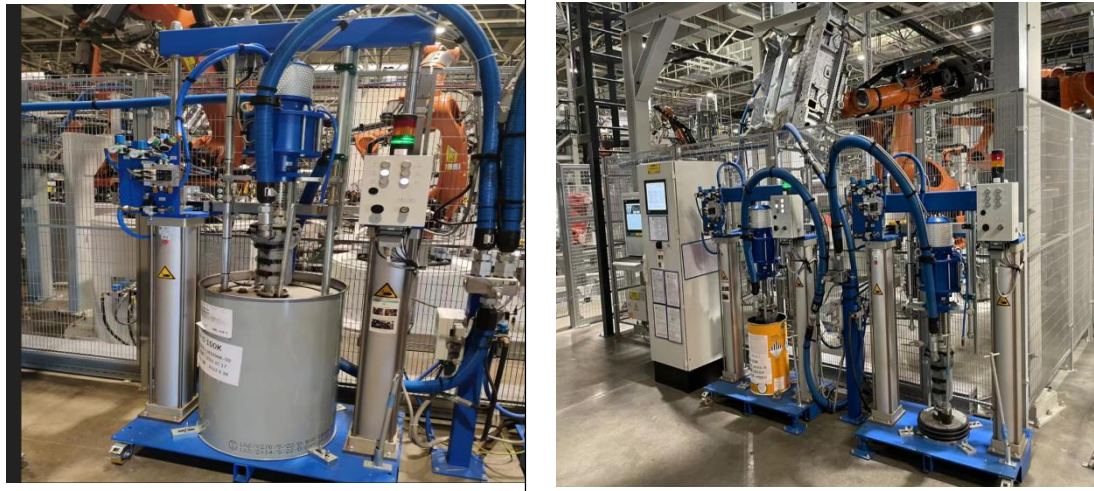
涂胶工序密闭管道输送
