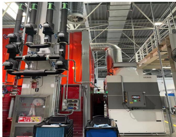
焊接烟尘净化系统
