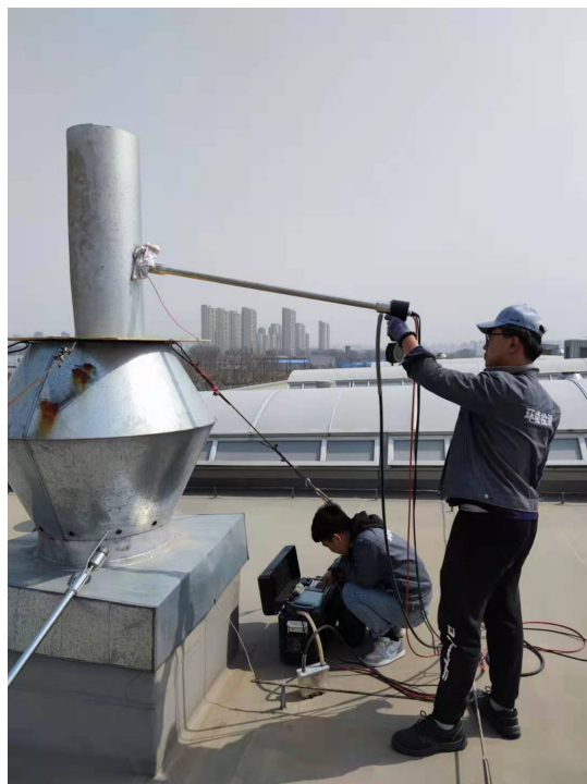
热处理空冷室排口 (FQ7)
