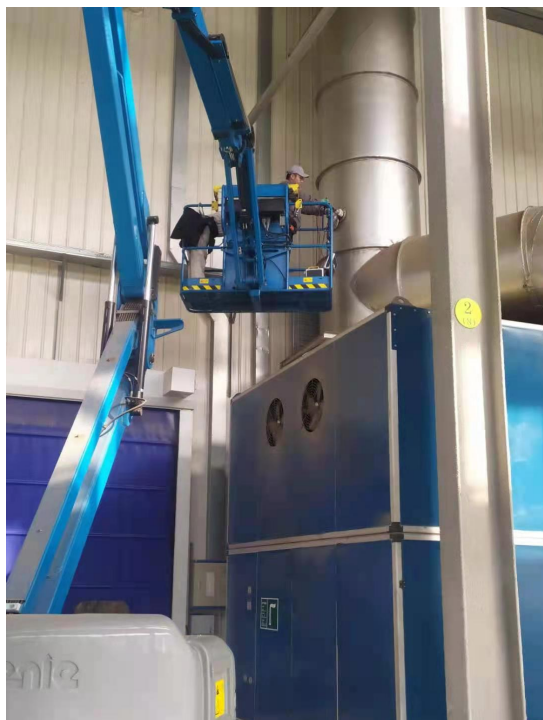
五合一（喷砂、浇注、冷却、精炼、除砂） 排口（FQ1）
